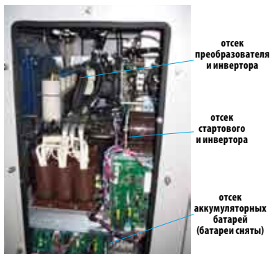
Рис. 16. Общий вид шкафа с силовой электроникой.
