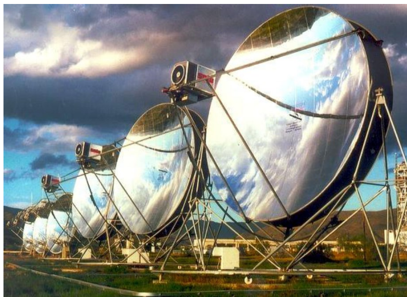
Рисунок 42 - Солнечная электростанция тарельчатого типа
