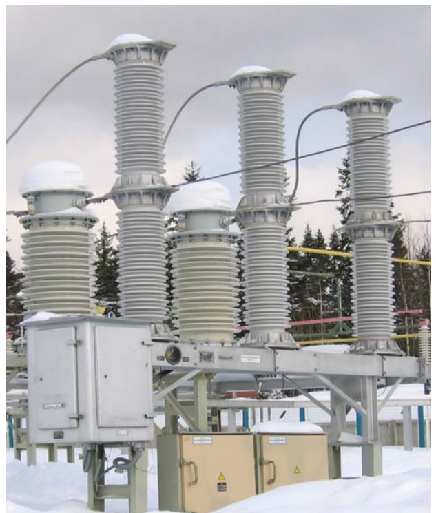
Рис. 2. Элегазовый выключатель ВГТ-110II-40/2500 (110кВ).
