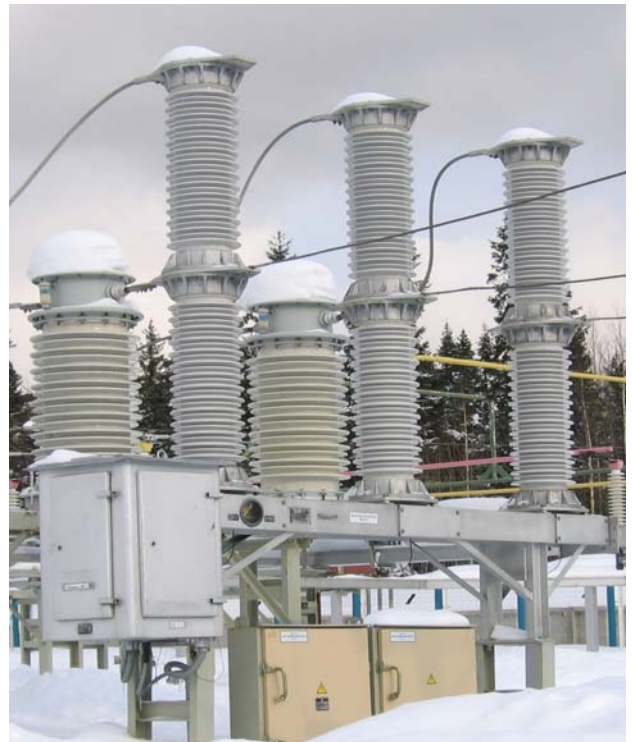
Рис. 2. Элегазовый выключатель ВГТ-110II-40/2500 (110кВ).
