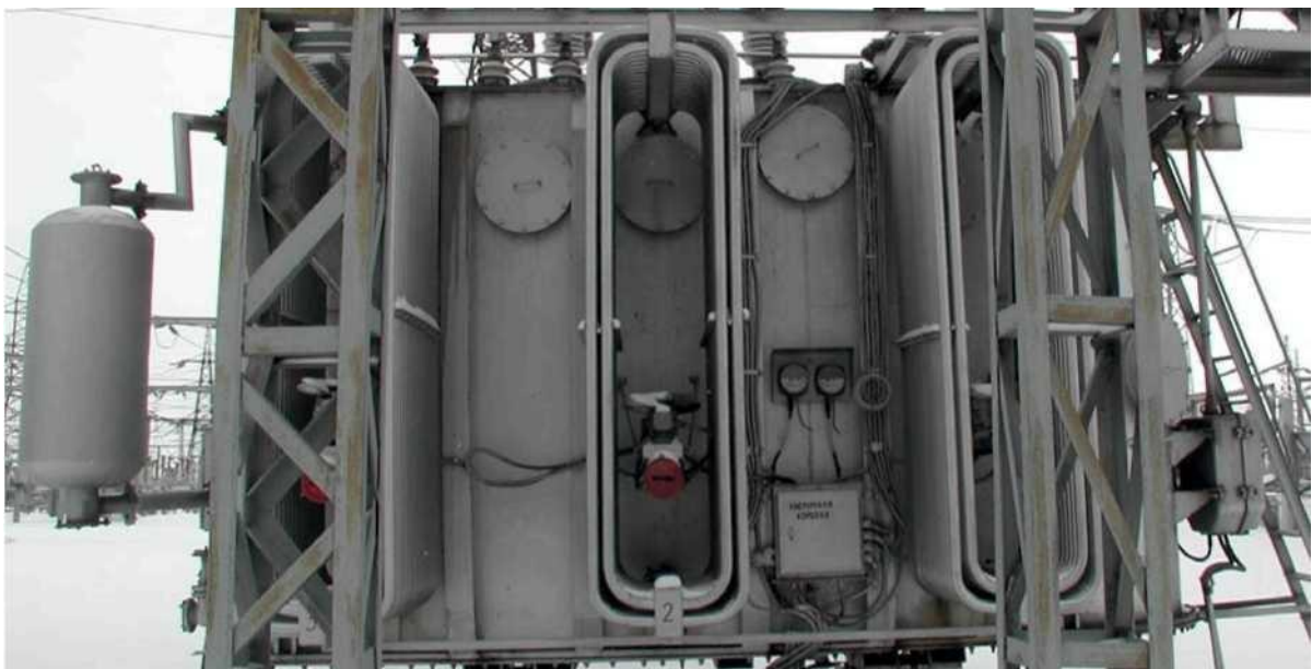
Отклонения: повышенная температура в области отводов НН1 и НН2, масло не циркулирует через термосифонный фильтр из-за закрытых шиберов
