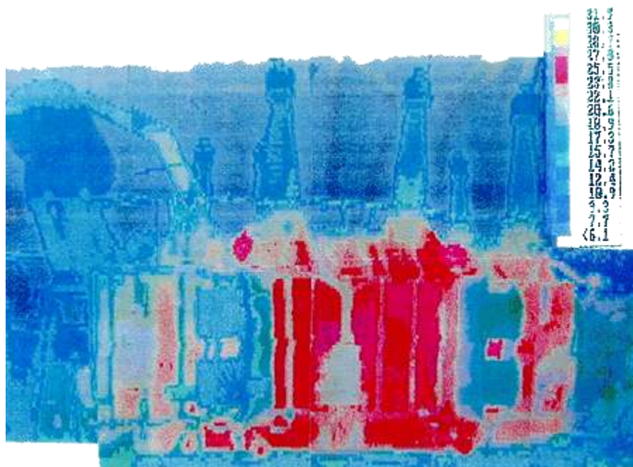
Термограмма поверхности бака силового трансформатора при отсутствии внутренних дефектов теплового характера
